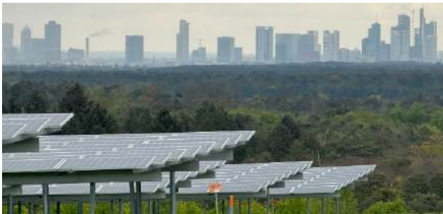
Buchschlag, größte Solaranlage Hessens
